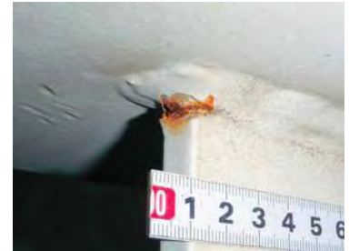
瀬戸大橋の車道を支える鉄製の溶接継手部分にあったき裂＝本州四国連絡高速道路提供
