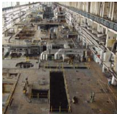
タービンホール
