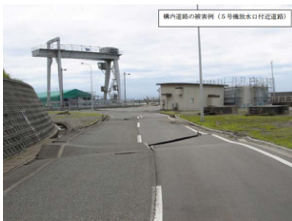
構内道路の損傷（放水口付近）
