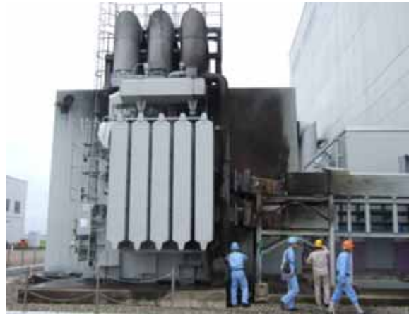
所内変圧器外観
