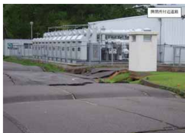
構内道路の損傷（開閉所付近）
